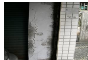
地下室柱爆裂
