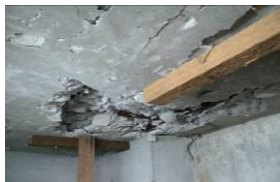
天花板鋼筋外露
