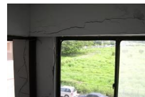
梯廳樑柱龜裂
