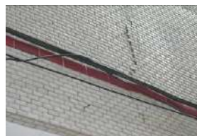
外牆立面龜裂
