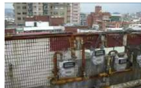
屋頂瓦斯表及管線
