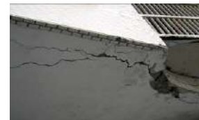
外牆鋼筋外露
