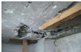
天花板鋼筋外露
