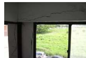
梯廳樑柱龜裂
