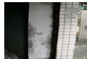
地下室柱爆裂
