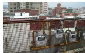
屋頂瓦斯表及管線
