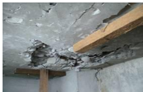
天花板鋼筋外露
