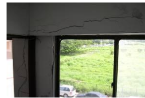
梯廳樑柱龜裂
