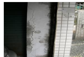
地下室柱爆裂
