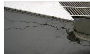
外牆鋼筋外露
