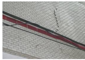
外牆立面龜裂
