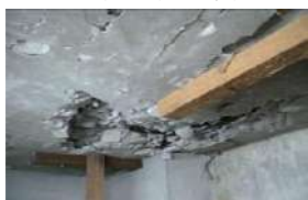
天花板鋼筋外露
