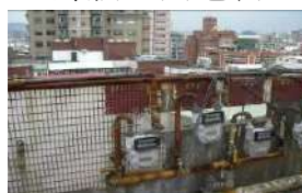
屋頂瓦斯表及管線
