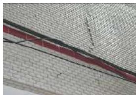
外牆立面龜裂
