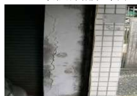
地下室柱爆裂
