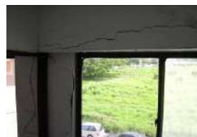
梯廳樑柱龜裂
