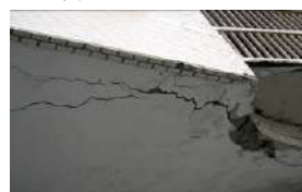
外牆鋼筋外露
